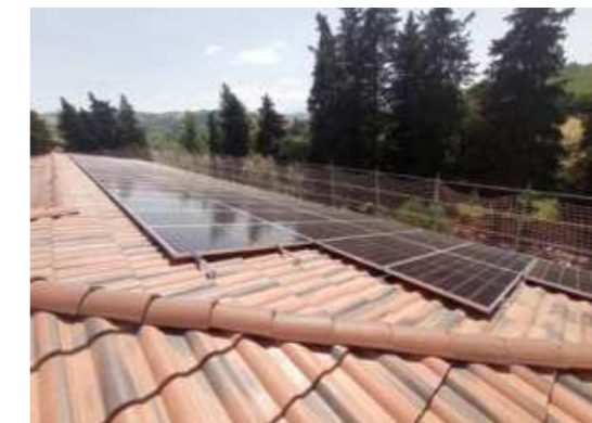
Completamento degli interni e dettaglio dell'impianto fotovoltaico da 30 kW.
