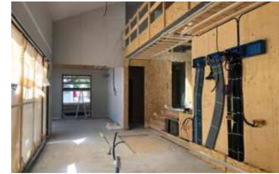
A sinistra, una vista complessiva del cantiere da sud mentre ci si approssima a chiudere il tetto; a destra, un dettaglio dell'allestimento interno degli impianti.
