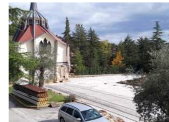
Preparazione della sede di cantiere; le fondazioni e la chiesa pronta ad accogliere il nuovo edificio in adiacenza.
